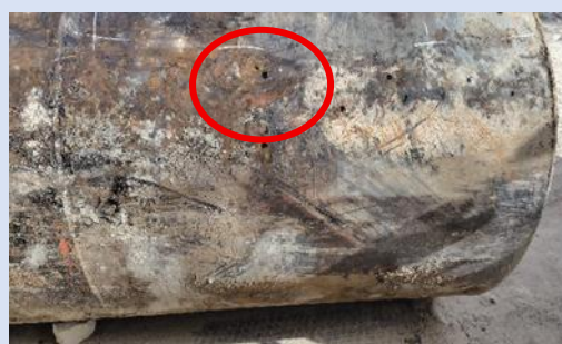
タンク本体(穿孔箇所)
