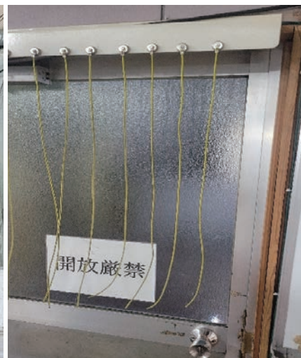
出入口の除電ロープ
