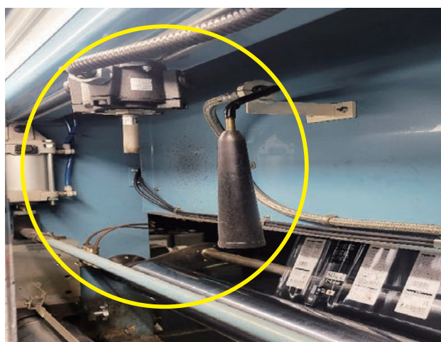
【危険物の真上に設置】
