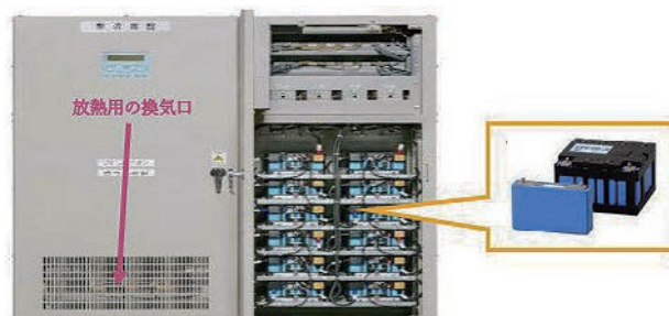
キュービクル式リチウムイオン蓄電池 (危険物施設におけるスマート保安等に係る調査検討報告書 p. 26)
